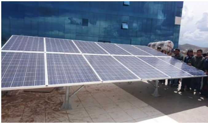
Fig. 1. SFcR-3.0kW, compuesto por una cadena de 12 módulos fotovoltaicos modelo SW150P. Instalados en el laboratorio EPIER-UNAJ.
