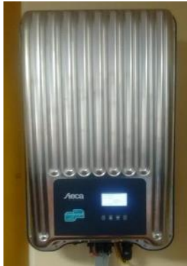
Fig. 2. Inversor String Modelo StecaGrid 3010-3kW., Instalado en el laboratorio EPIER-UNAJ.
